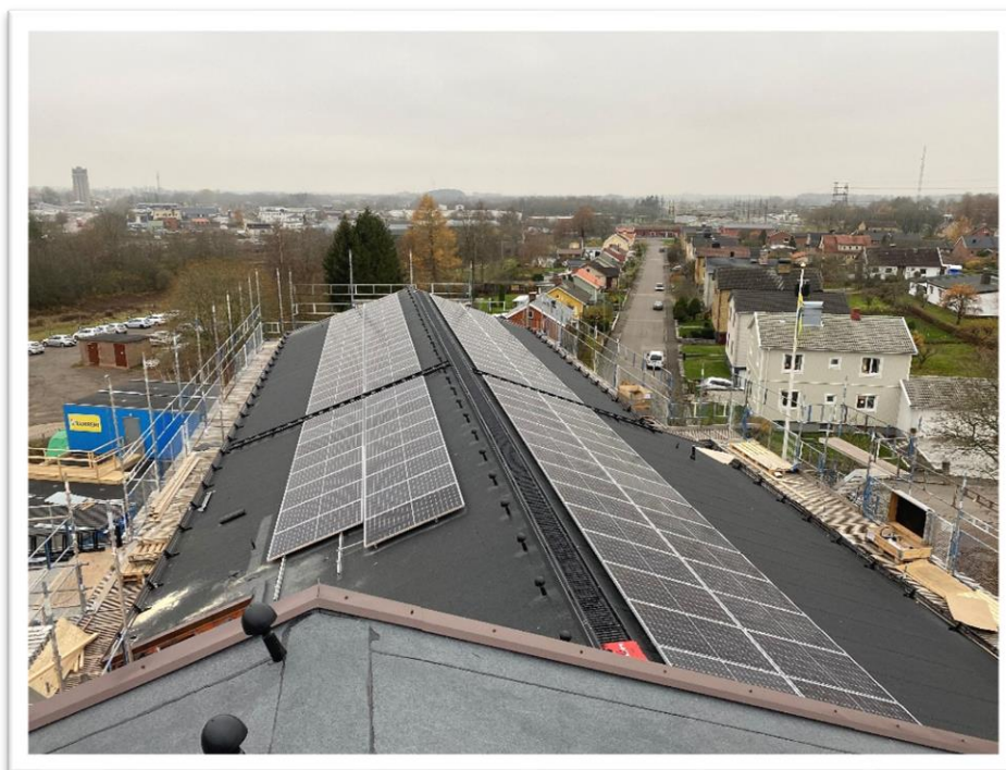
Installerad solcellsanläggning i samband med ombyggnation av Ranliden
